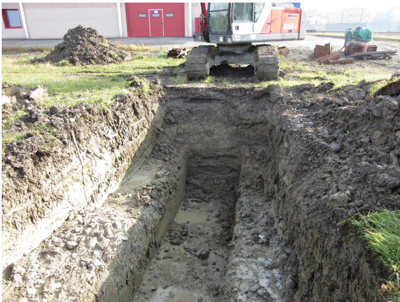
Foto n.6: sondaggio eseguito il 30 gennaio per valutazioni archeologiche. Si evidenzia l'assenza della falda sospesa presente più a nord (foto n.5); la presenza delle argille azzurre al fondo con una modestissima raccolta di acque.
