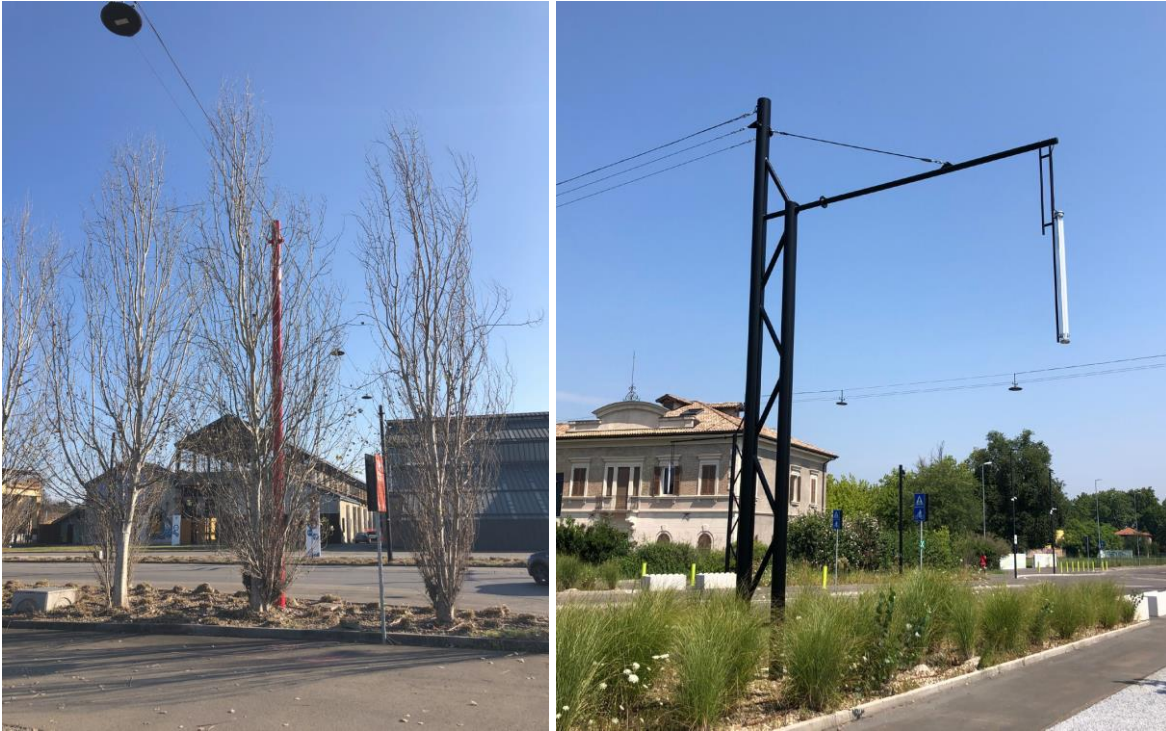
Figura 22 – Foto del sistema a tesate già realizzato in viale Ramazzini e Piazzale Europa.
