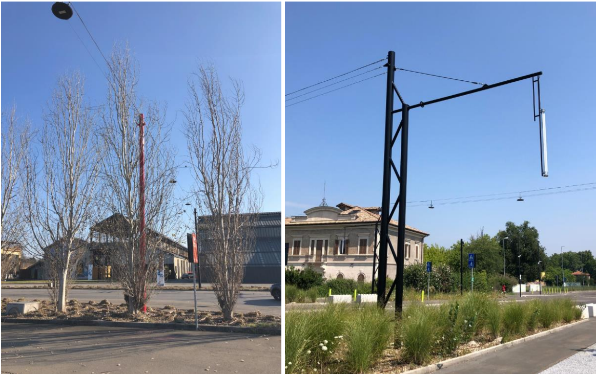
Figura 22 – Foto del sistema a tesate già realizzato in viale Ramazzini e Piazzale Europa.
