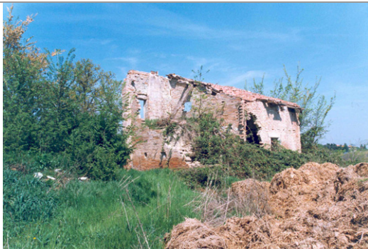
Foto Costa cod. 28D16-1 Basso servizio, oggi crollato
