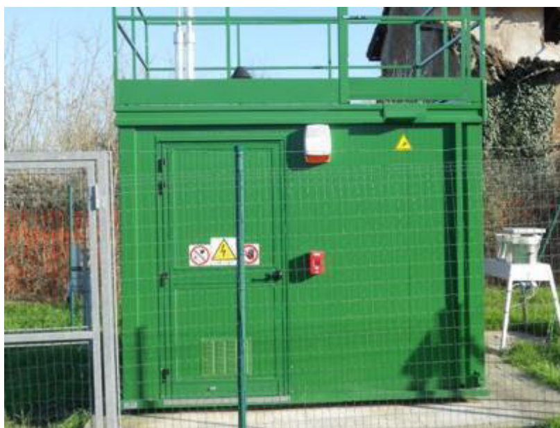
Stazione di monitoraggio di San Lazzaro
