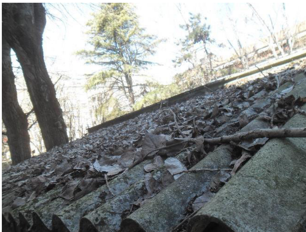
Foto 3: tettoia, particolare e stato di conservazione scadente
