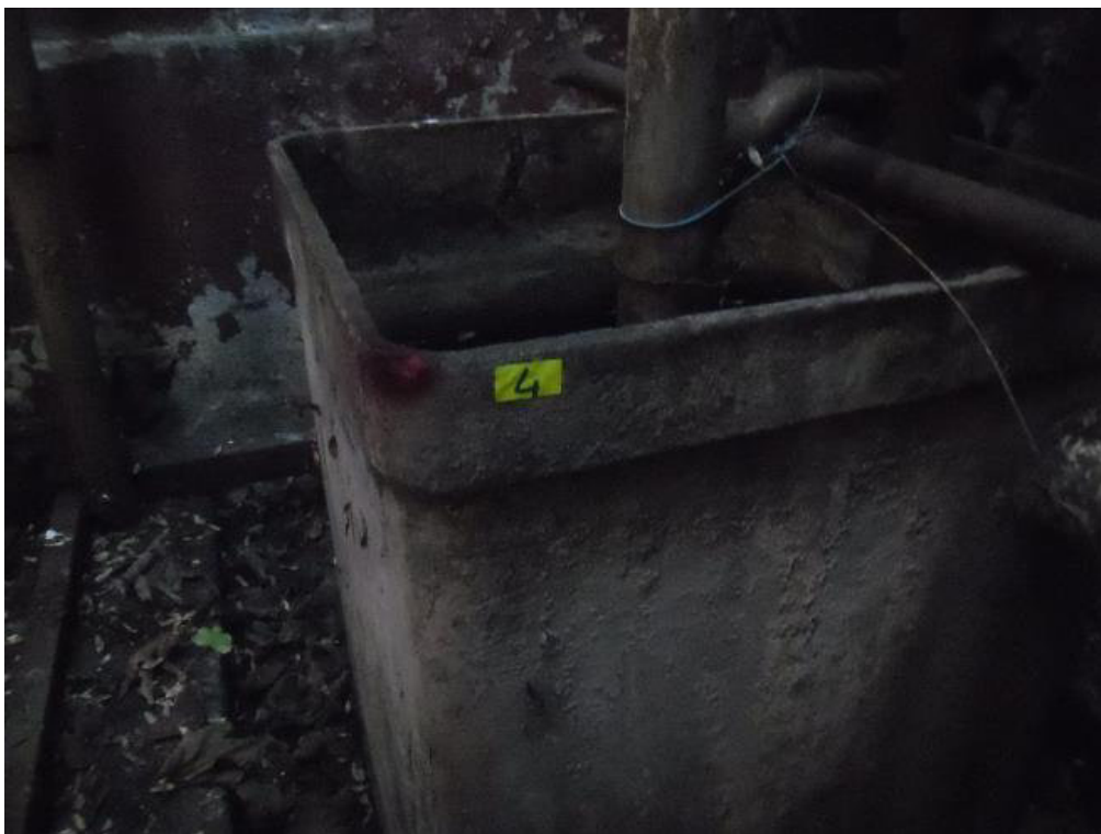
Foto 6: campione 4, serbatoio vistosamente ammalorato
